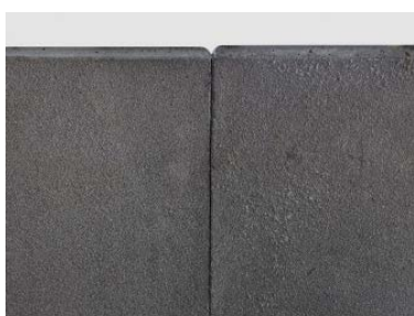
Accostamento pannelli senza fuga. POSA SCORRETTA. Non c'è spazio per le dilatazioni termiche e per la sigillatura.
